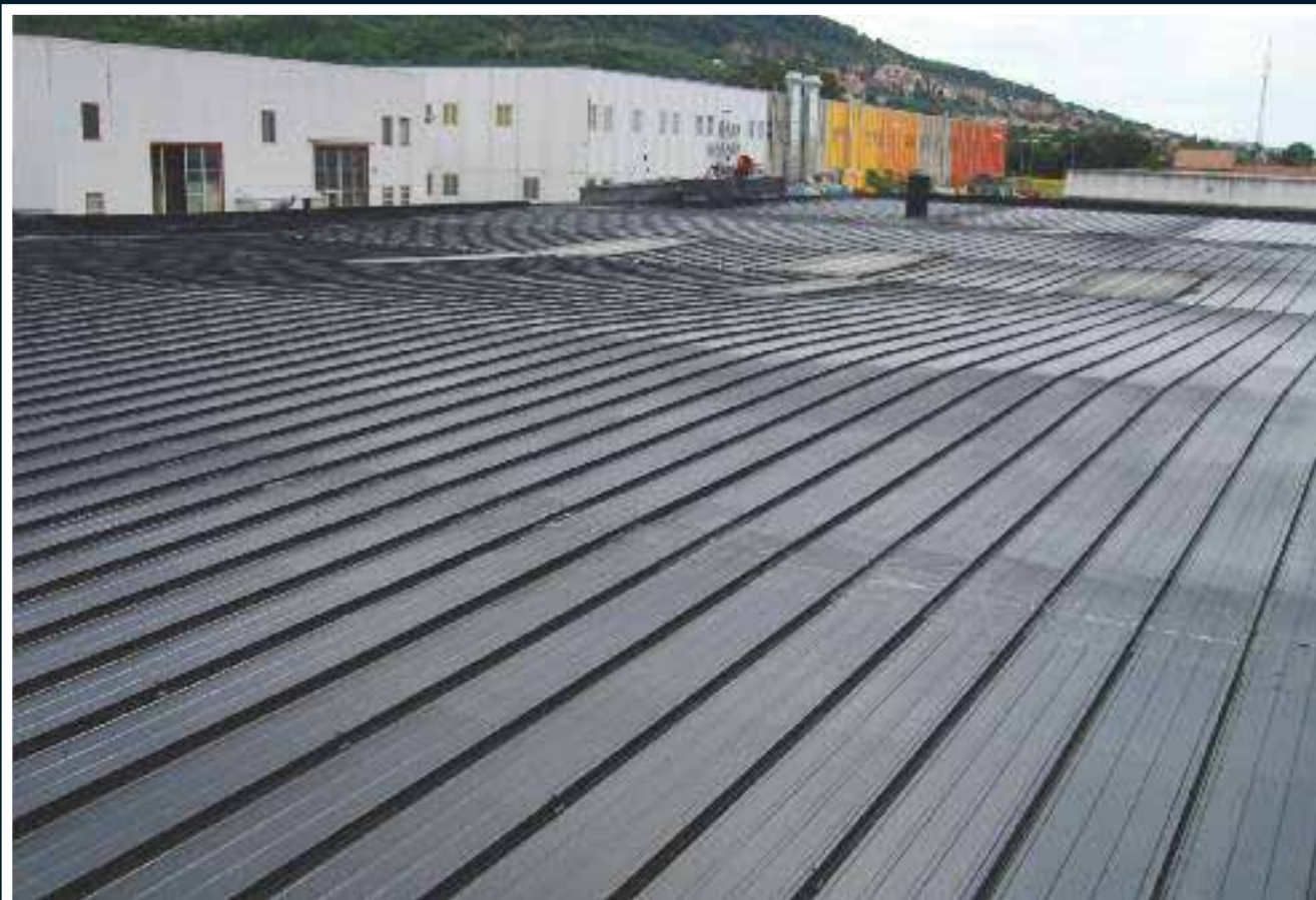
Aspect de la couverture métallique après le traitement réalisé avec deux couches d' ElastiK appliquées à un intervalle de 48 heures entre chaque couche (application par pulvérisation pour une consommation totale de 1 kg/m 2 )
